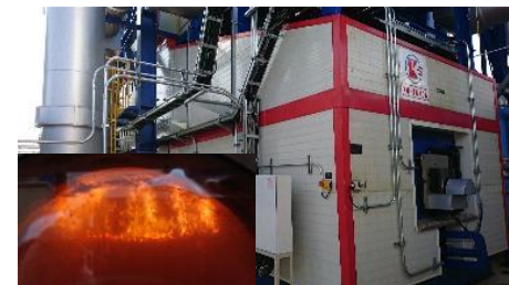
バイオマス燃焼炉
