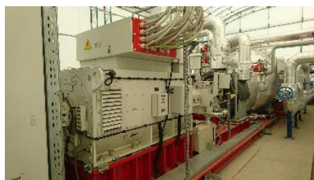
ORC発電設備
