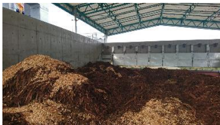
原料投入ウォーキングフロア
