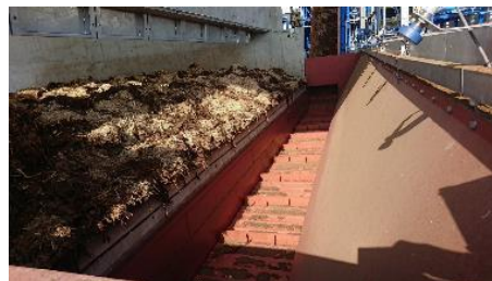
原料投入エプロンコンベア
