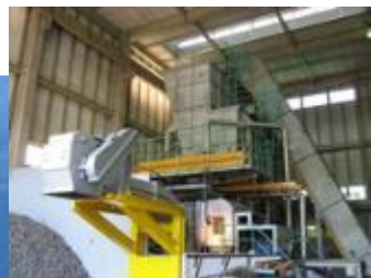
固形燃料化施設
