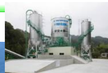
造粒固化施設
